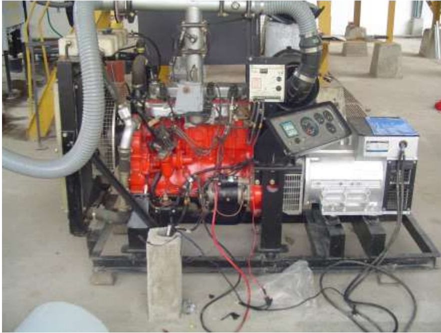
Fotografía # 17 Grupo motor generador de 30 kVA.
